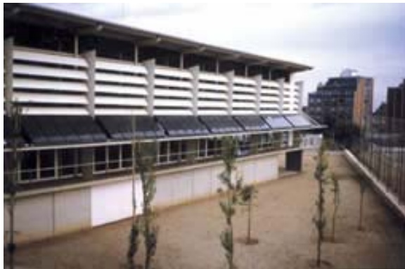
Figure 42. Solar thermal installation, acting as shading devices on the façade of the Poliesportiu Municipal del Guinardó Torrent d'En Melis, Barcelona [source: Agència d'Energia de Barcelona]
