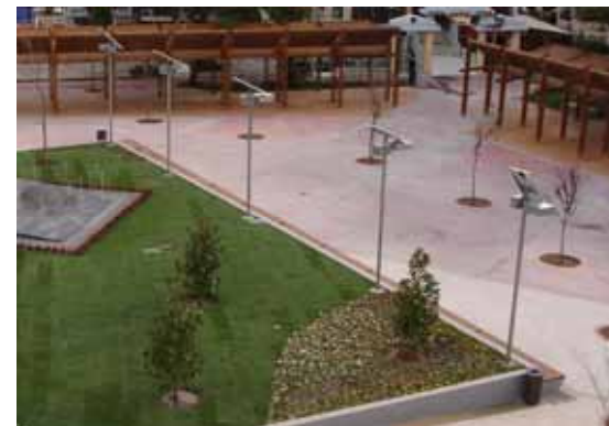
Εικ. 4.3.2: Τοποθέτηση Φ/Β σε φωτιστικά σώματα για το φωτισμό της πλατείας Αναλήψεων στο Δήμο Βριλησίων
