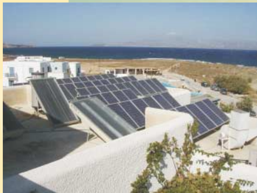
Ξενοδοχείο Philoxenia στην Πάρο: Φ/Β σύστημα, ονομαστικής ισχύος 10 kWp, συνδεδεμένο με το δίκτυο της Δ.Ε.Η.
