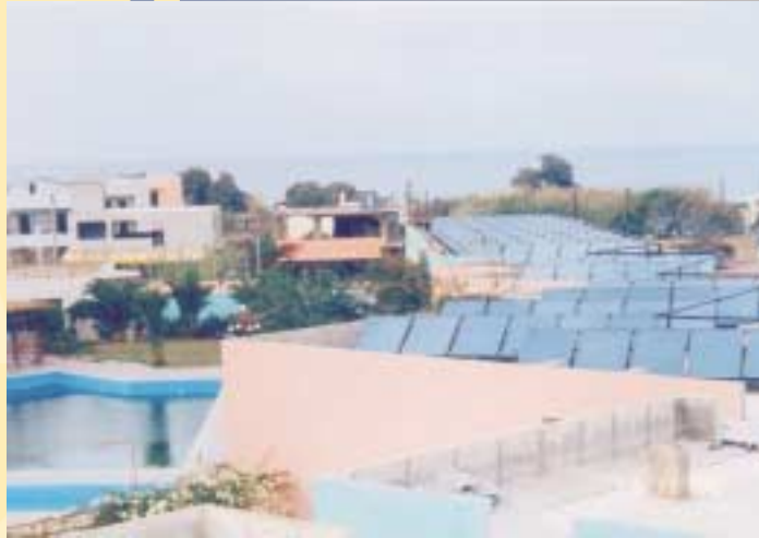
Το ηλιακό σύστημα στο «Rethymno Village», στην Κρήτη (647 τ.μ.) το οποίο εξασφαλίζει ζεστό νερό για το σύστημα ηλιακού κλιματισμού του ξενοδοχείου καθώς και για την θέρμανση της πισίνας του
