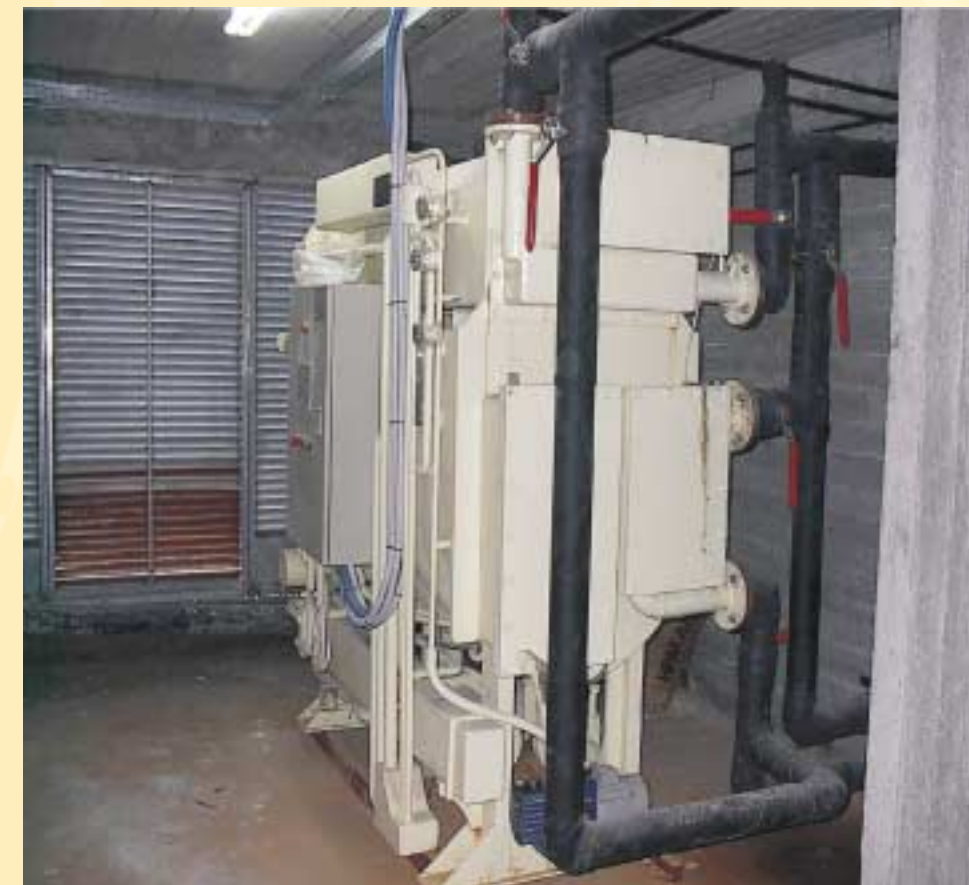
Ο ψύκτης απορρόφησης, ονομαστικής ισχύος 105kW του ξενοδοχείου Λετζάκης στην Κρήτη, που τροφοδοτείται με ζεστό νερό από 450 τ.μ. επίπεδων ηλιακών συλλεκτών
